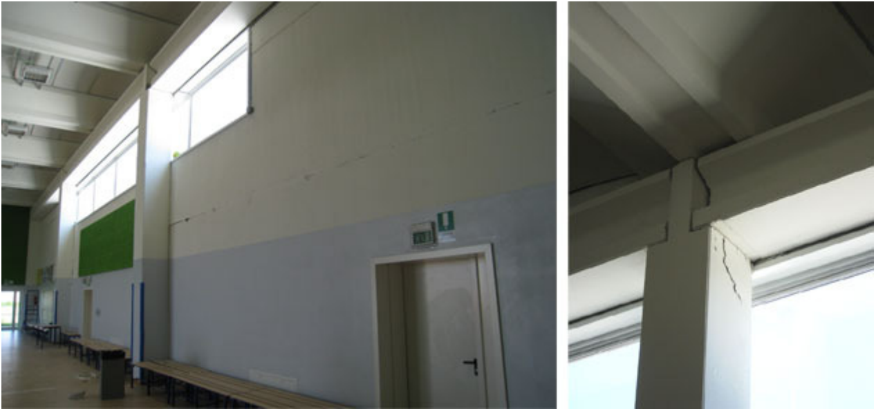
Fig. 4 - Danni e fessure agli elementi non strutturali e strutturali della palestra della scuola primaria di Mortizzuolo di Mirandola, in elementi prefabbricati, dichiarata inagibile.
