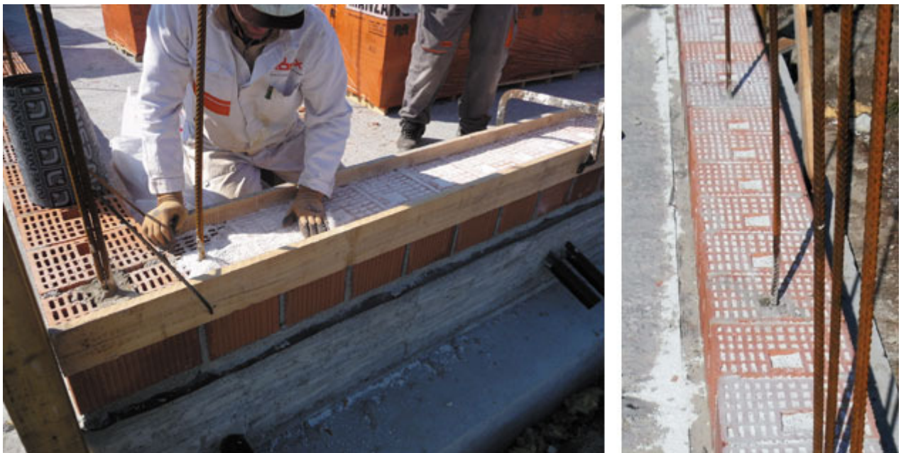
Fig. 3 - Fase di riempimento con perlite del primo corso di blocchi in laterizio portante armato.
