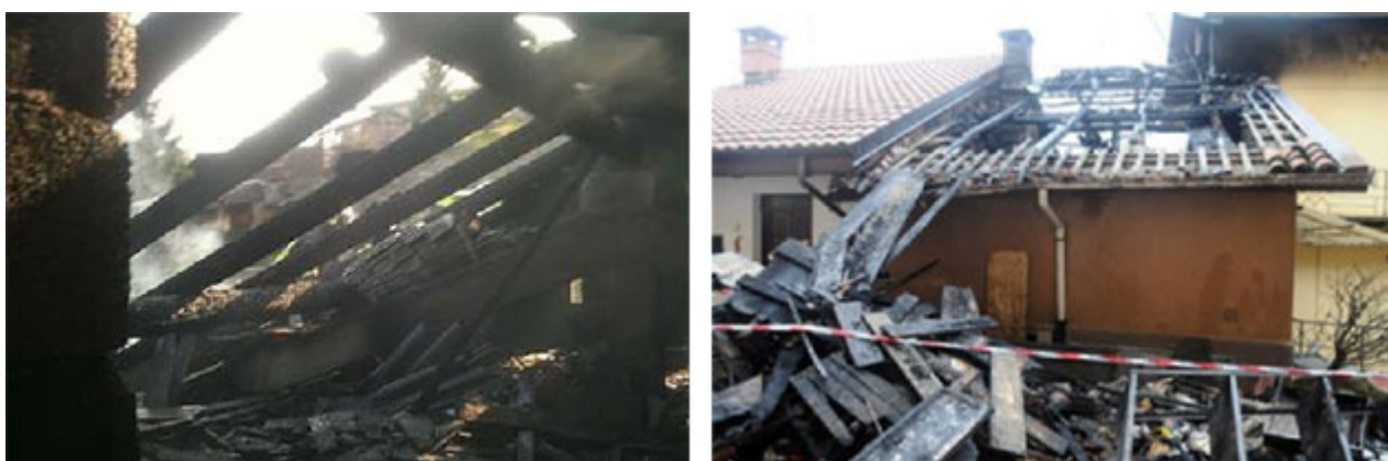
Fig. 2 - Incendio su edificio residenziale in provincia di Sondrio (sx - fonte: vaol.it ) e Biella (dx - fonte: lastampa.it ).
