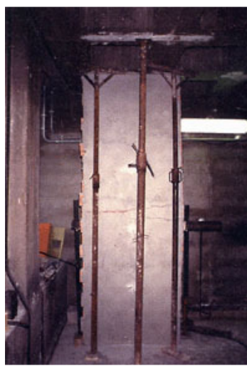
Fig. 5 - Prova su pannello tipo -9-: inizio fessurazione.
