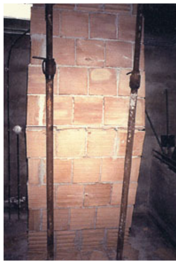
Fig. 3 - Pannello tipo -4- dopo il collasso (vista frontale).
