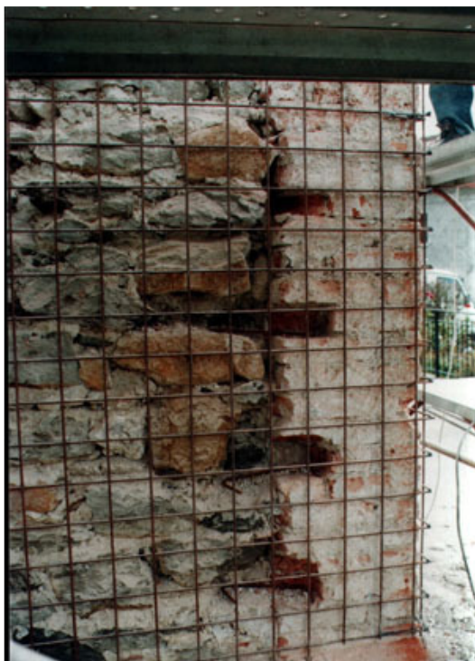
Fig. 1 - Creazione nicchie di alloggiamento per la miscela cementizia ed applicazione rete elettrosaldata.
