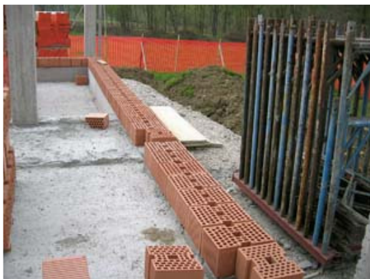
Fig. 3 - La posa a secco del primo corso di blocchi serve per individuare esattamente la posizione in cui dovranno essere inghisate nella fondazione le barre di armatura verticale, che verranno poi fissate con una adeguata miscela ancorante nei fori che si andranno a predisporre nella fondazione stessa.
