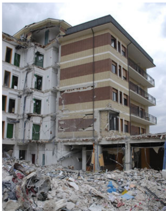
Un edificio in c.a. parzialmente crollato e con danneggiamenti ai tamponamenti a L'Aquila.
