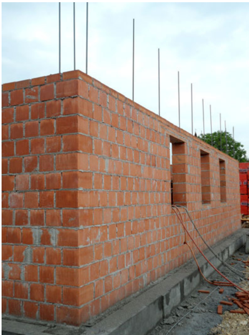
Fig. 3 - Muratura armata POROTON®, prima elevazione con le armature verticali che sporgono per fungere da chiamata per il piano superiore. Si notino la pulizia della muratura nell'angolo e nella sua estensione.
