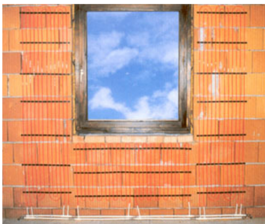
Fig. 2 - La struttura capillare di tubazioni che compone un impianto di riscaldamento radiante a parete viene fissata alla muratura e poi intonacata e/o rivestita con pannelli di varia natura.
