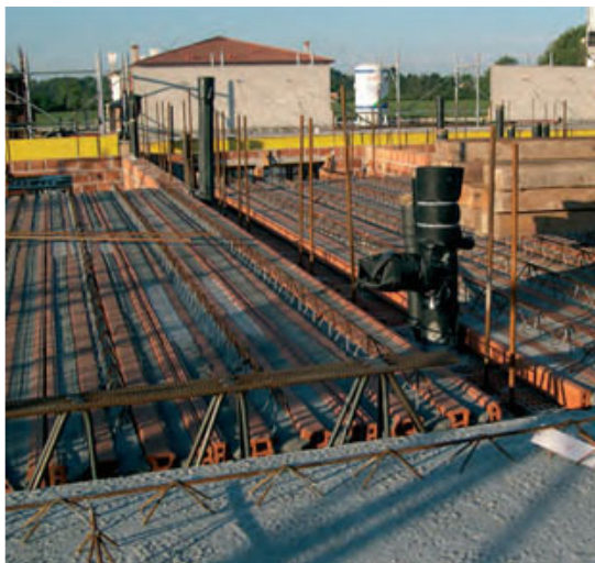
Fig. 4 - Nodo tra solaio in latero-cemento, fondo poggiolo prefabbricato e tubazioni di scarico acusticamente isolate e disaccoppiate.
