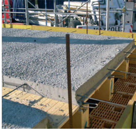
Fig. 5 - Nodo solaio prefabbricato in legno calcestruzzo e struttura verticale portante in muratura armata in laterizio POROTON®.
